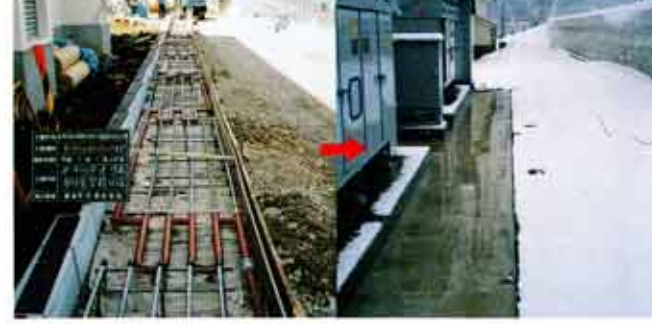
ボイラ熱源(磐越自動車道中山トンネル)
