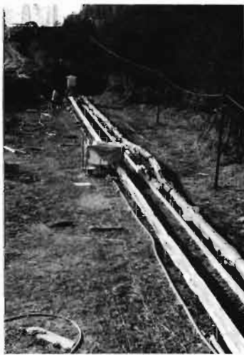
図 11 100 m 長尺ヒートパイプの試験装置の全景 Overall view of testing setup of a 100 m long heat pipe
