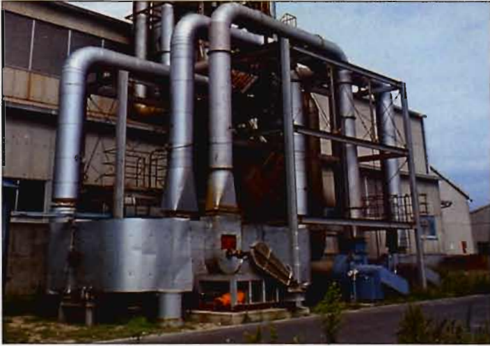
● 熱風回収形実験機全景
