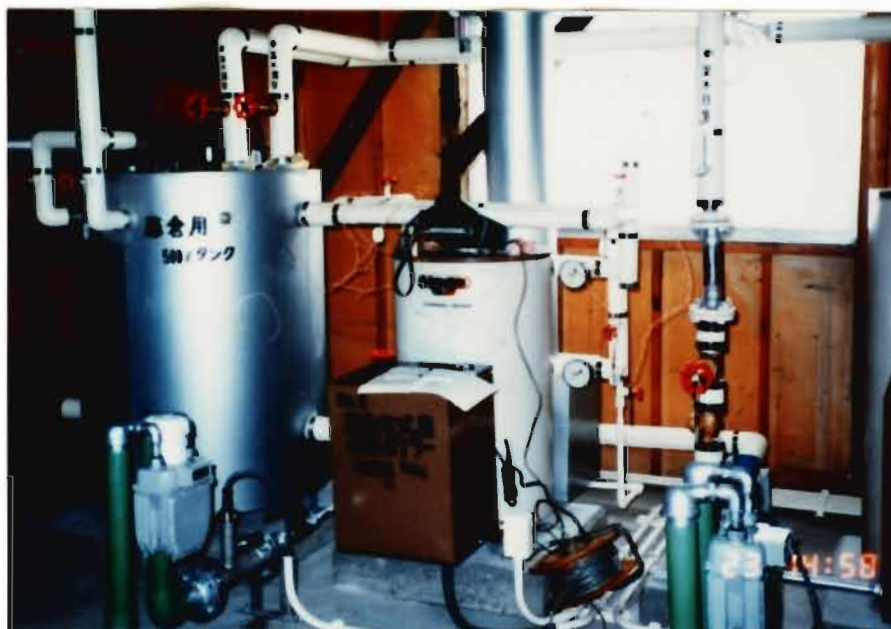
ボイラー熱源型システムの基本的機械室 (新潟県柏崎市ガス水道局殿)
