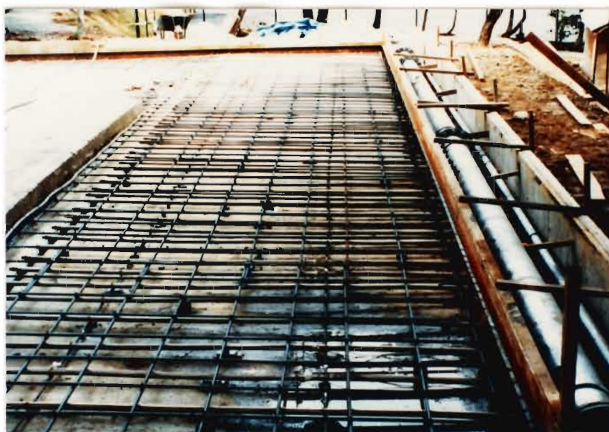
ボイラー廃ガス利用による駐車場の融雪 (白馬スカイラインホテル殿)
