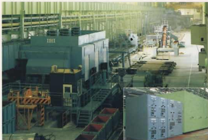
▲F型パワーキッカーが組込まれた大型圧延機用制御装置
